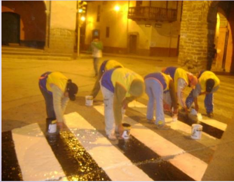
Señalización en vías públicas
