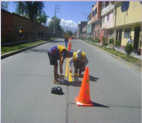
Señalización en vías públicas
