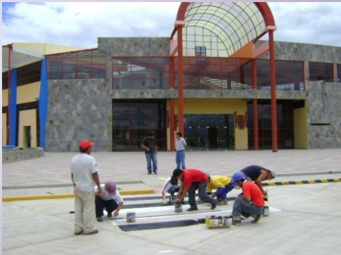
Señalización en vías públicas
